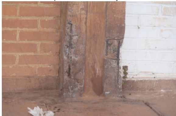
Figura 4: Detalhe da estrutura de concreto aparente – Carbonatação do concreto e corrosão da armadura de aço
