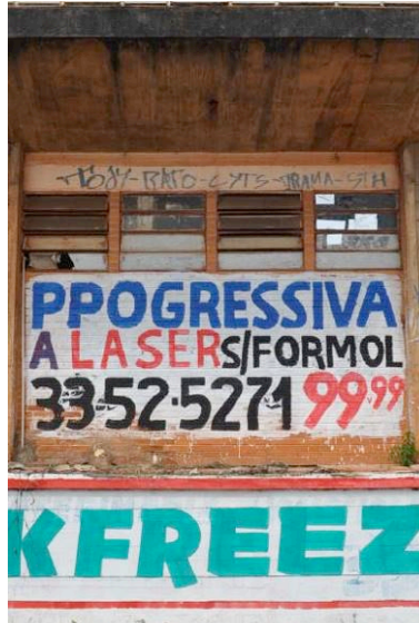
Figura 6: Trecho da Fachada Leste – Patologias dos Tijolos Cerâmicos (Pichações e propagandas)
