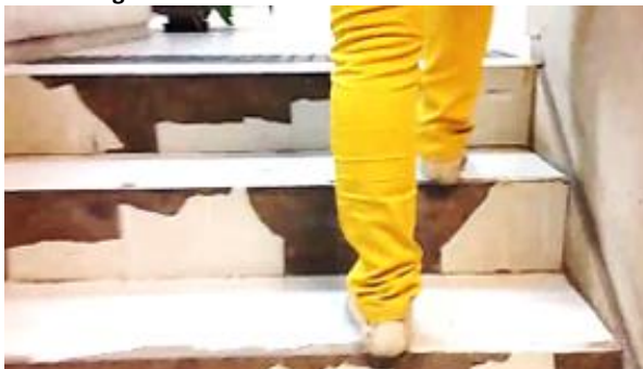
Figura 5: PSD – Revestimento danificado
