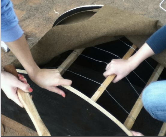
Figura 14: Parte do processo de execução –colocação do carpete para prover a superfície do fundo da fôrma.
