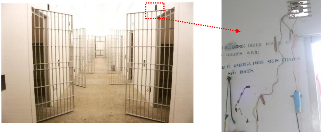
Figura 7: Foto corredor com nicho de iluminação e detalhe da modificação do controle de iluminação
