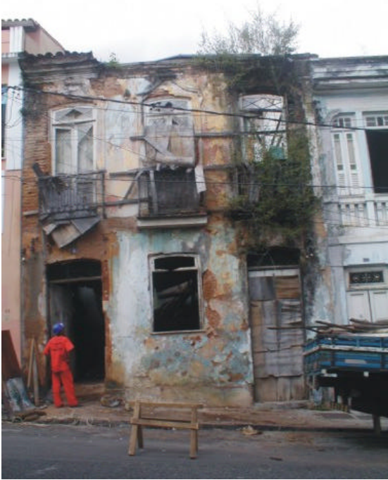
Figura 1 – Foto de ruína existente no local semelhante às utilizadas
