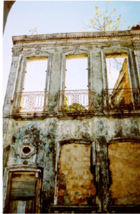
Figura 2 – Foto de ruína existente no local semelhante às utilizadas
