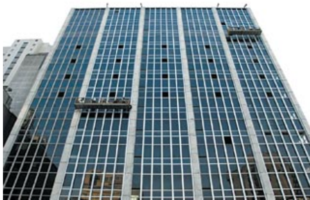
Figura 7 - Perfis de alumínio, com espessuras variáveis entre 1,2 e 1,8 milímetro, recobrem a antiga caixilharia
