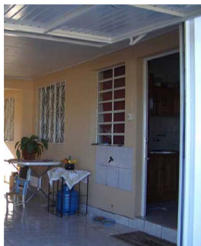
Figura 2: ampliação que privou de luz natural quartos e cozinha. Fonte: foto da autora.
