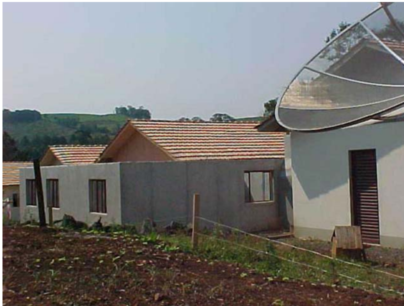
Figura 1: ampliação em andamento onde se observa o enclausuramento da edificação original. | Fonte: foto da autora.
